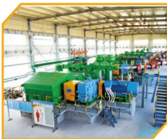
乌山铜钼矿使用国内自主研发的最大隔膜泵，输送膏体尾矿时工作流量达到630立方米/小时，具有高效节能的特点，堪称中国矿业尾矿输送工艺的一次飞跃
